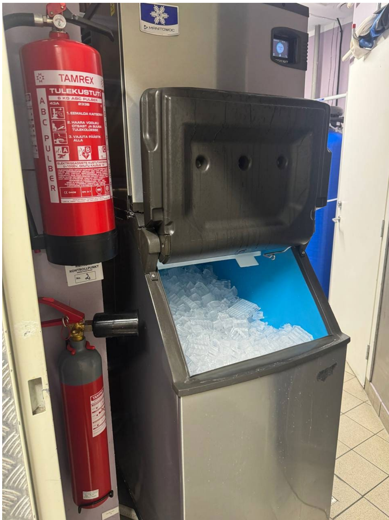
Рисунок В.2 – Фактичне розташування вуглекислотного та порошкового вогнегасників поруч із технічним обладнанням
