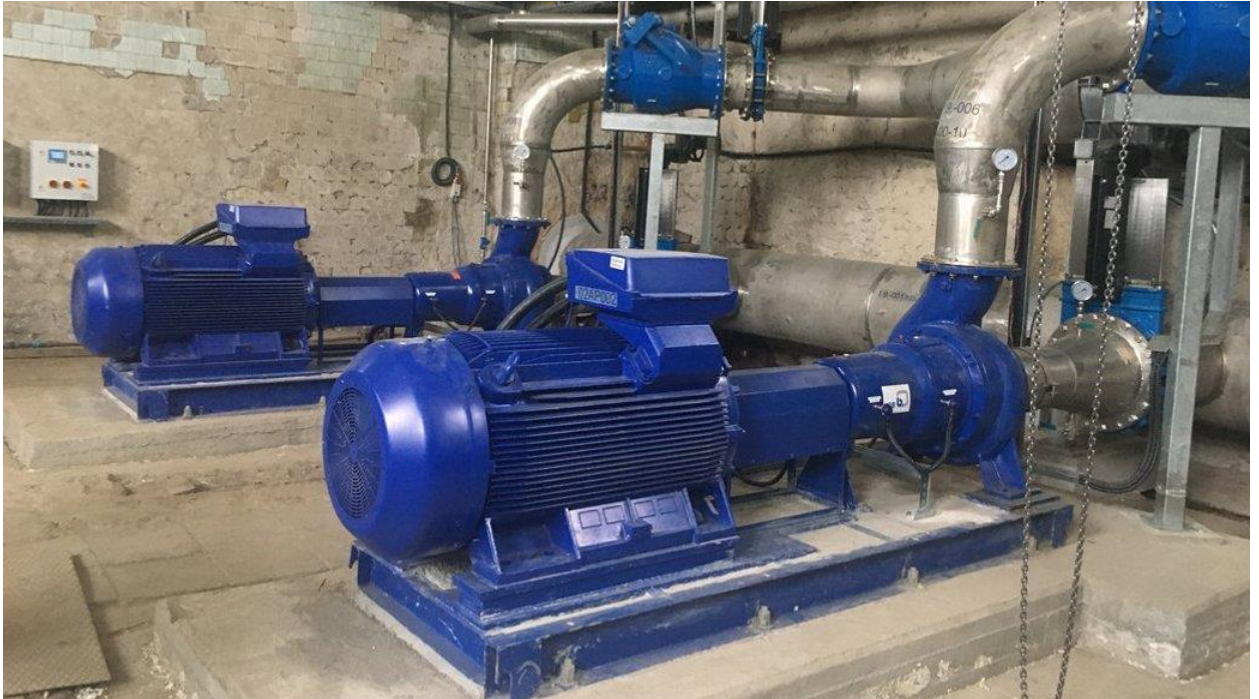
Рисунок 3.1 – Насосні агрегати каналізаційної насосної станції
