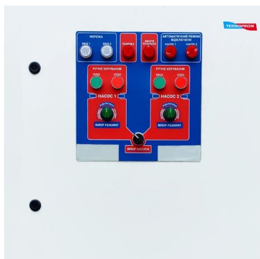
Рисунок 3.2– Щити керування насосними агрегатами КНС
