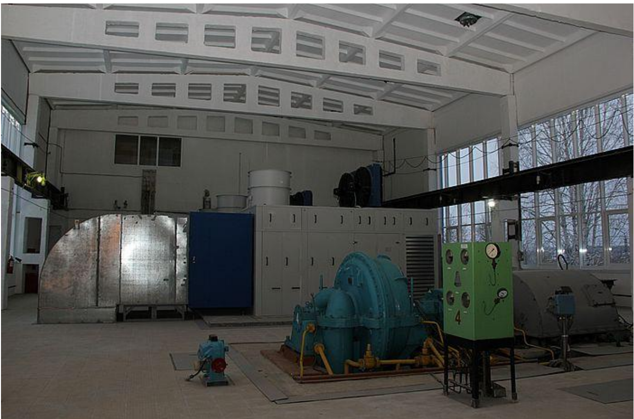
Рисунок 16.3 – Повітродувна станція аеротенків
