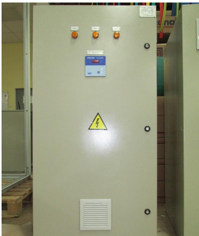
Рисунок 3.4 – Приклад розміщення знаку W012 на дверях електрощитової
