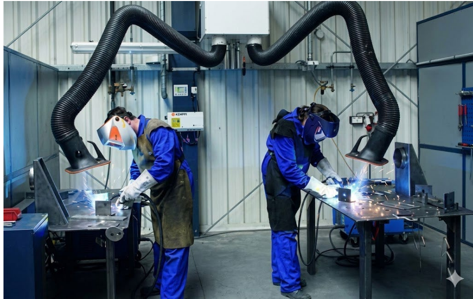
Рисунок 2.2 – Система вентиляції на робочих місцях ділянки зварювання
