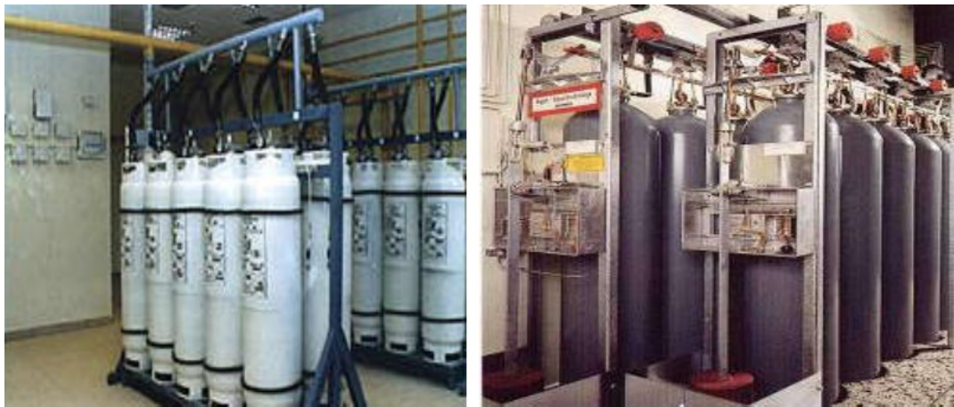
Рисунок 3.11 – Автоматична установка газового пожежогасіння [23]
