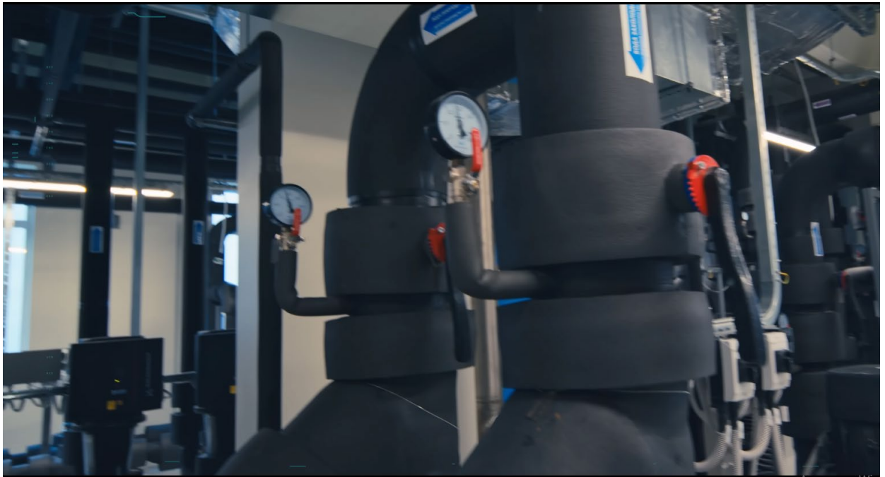
Рисунок 1.9 – Технічне приміщення підготовки повітря
