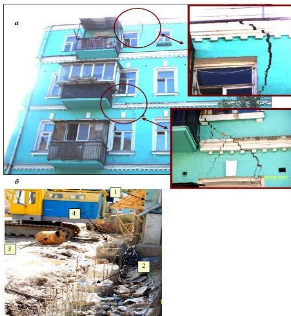
Рис. 1.2. Деформування конструкцій будинку № 112 по вул. Жилинській в м. Києві внаслідок влаштування вздовж бокової стіни буронабивних паль в обсадних трубах: а – загальний характер деформування стін будинку; б – вид на буронабивні палі та обсадні труби, влаштовані вздовж бокової стіни будинку; 1 – бокова стіна; 2 – готова буронабивна паля; 3 – буровий ківш; 4 – обсадна труба
