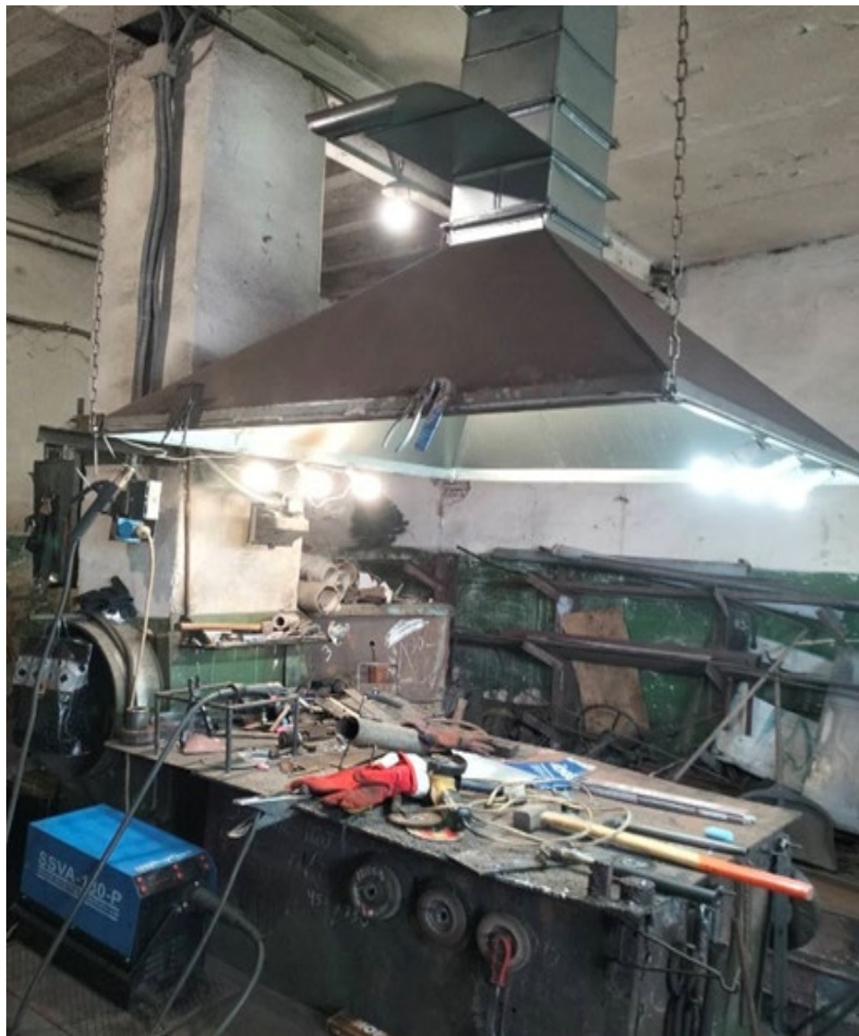
Рисунок 2.2 – Зварювальний пост ремонтного боксу КАТП-052810
