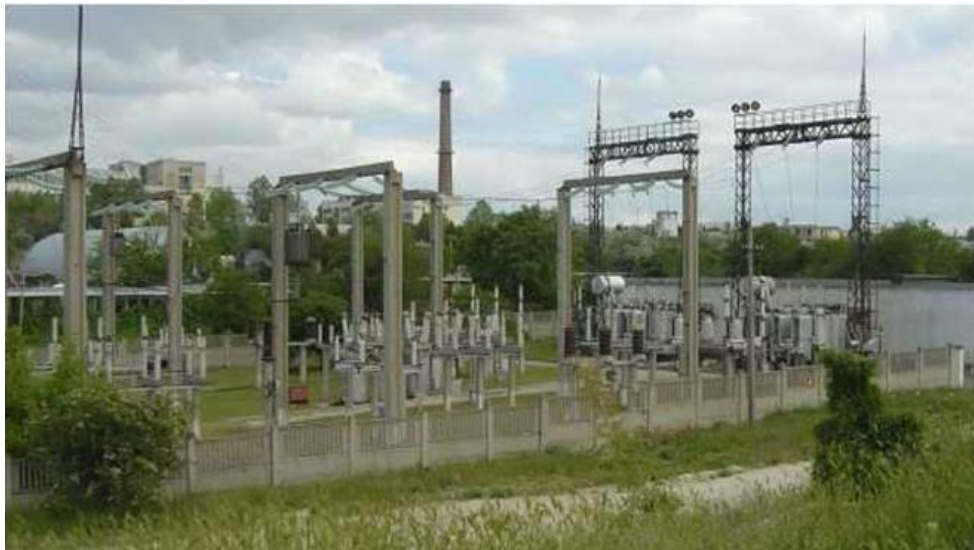
Рисунок 1.4 – Районна підстанція 110/10 кВ
