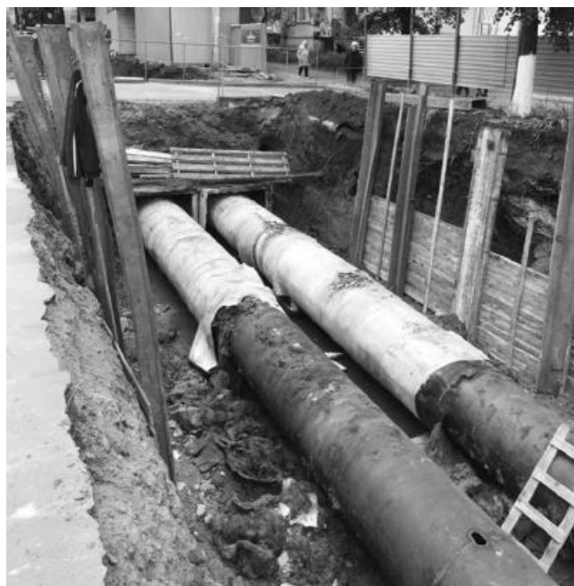
Рисунок 1.2 – Існуюча магістральна тепла мережа діаметром 820 мм перед заміною її на нову попередньо ізольовану [2]
