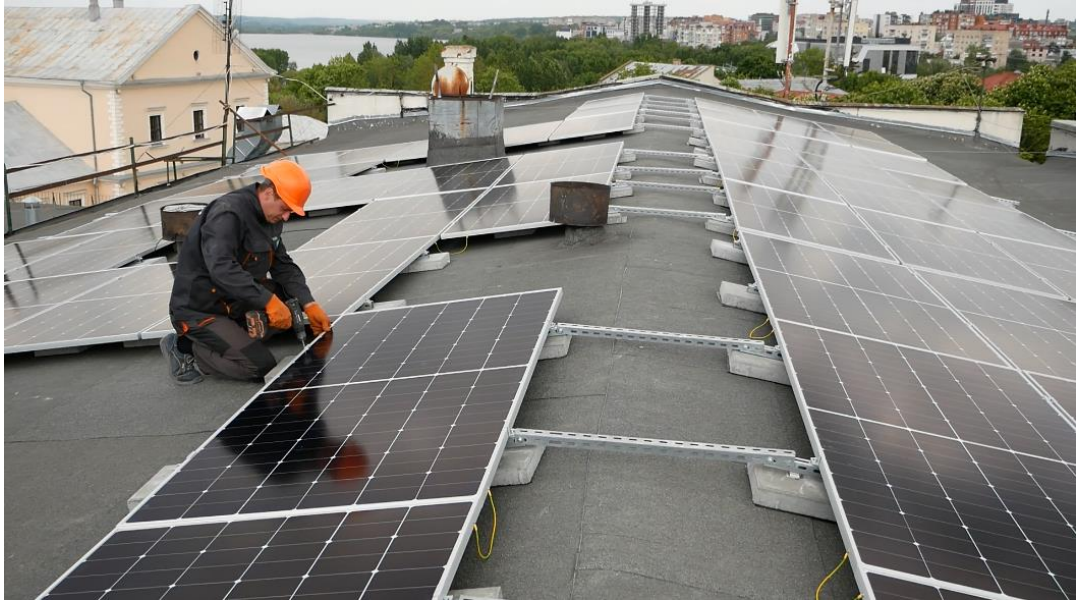
Рис. 3.4. Сонячна електростанція для готелю Тернопіль [40]
