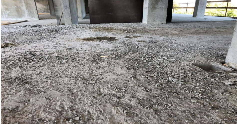
Рисунок 1.3 – Наявний дефект: відшарування поверхневого захисного шару залізобетону
