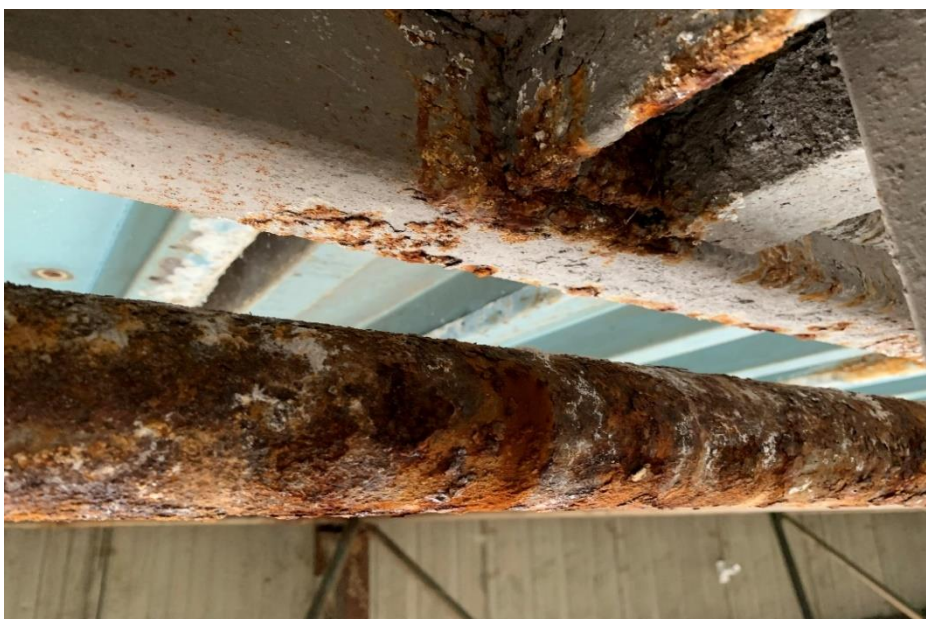
Рисунок 1.6 – Найвний дефект: корозія металевих структурних елементів
