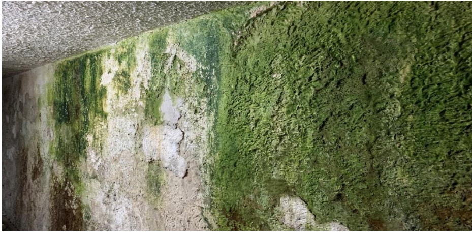
Рисунок 1.7 – Найявний дефект: зелена пліснява (грибок) у підвальних приміщеннях
