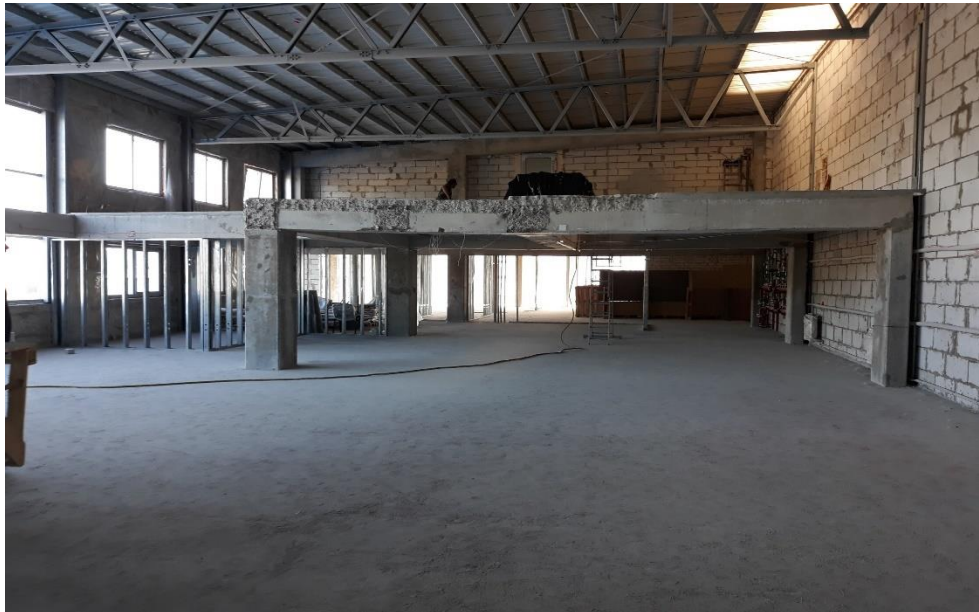
Рисунок 1.4 – Наявний дефект: ненормативний прогин монолітного залізобетонного ригеля (бантини)
