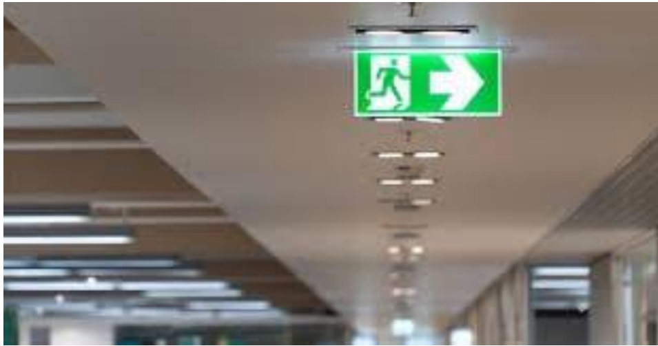
Рисунок 4.4 – Вказівники виходу з приміщень будівлі
