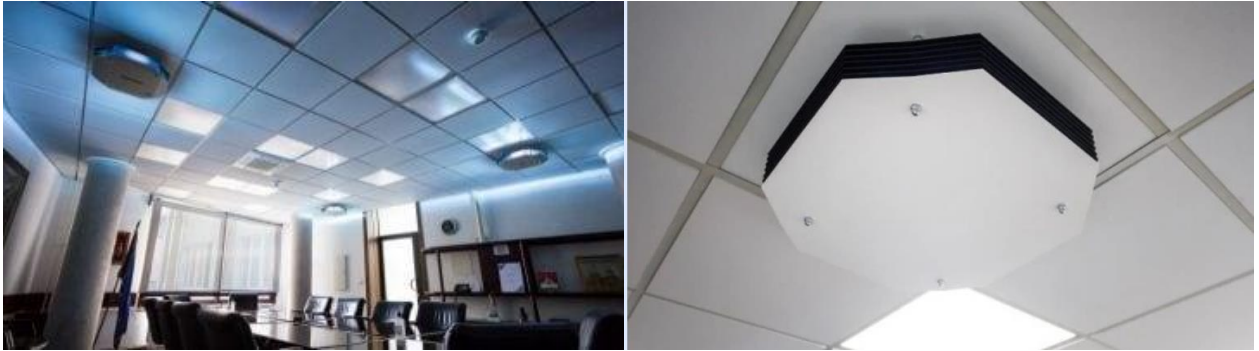
Рисунок 4.9 – Приклад встановлення знезаражувачів для приміщень громадських будівель
