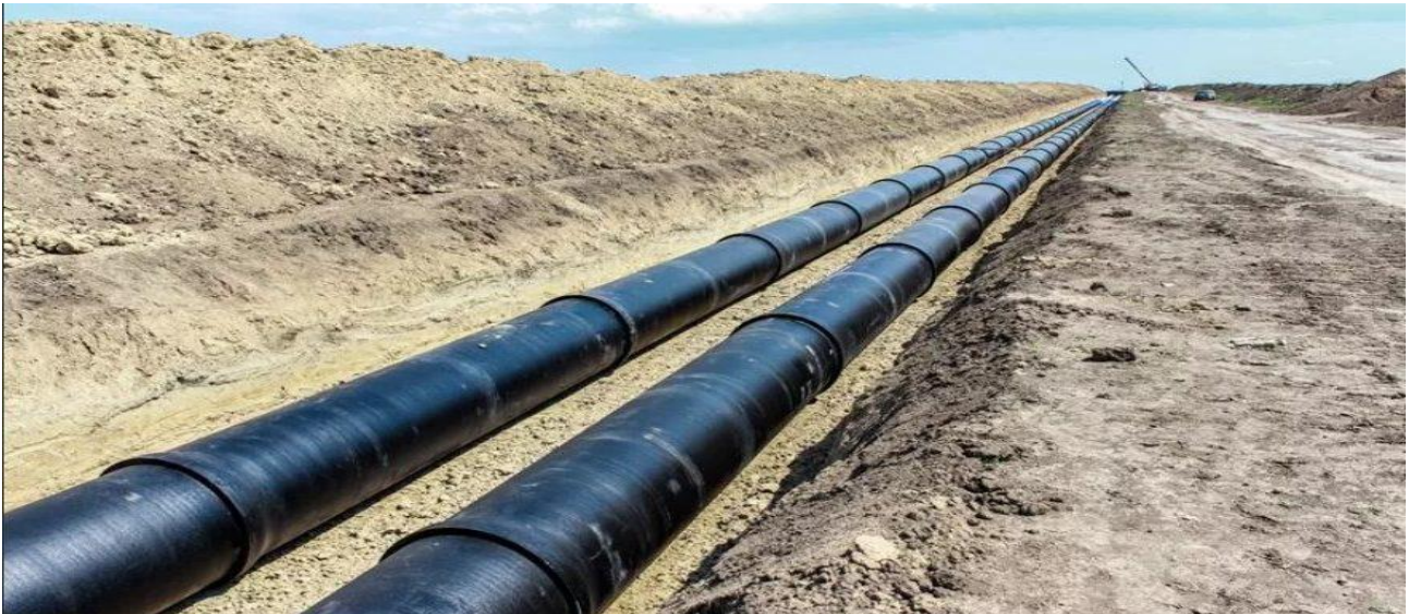
Рисунок 8.24 – Магістральний водовід (фото з відкритих джерел)
