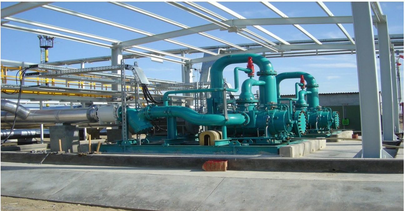
Рисунок 7.6 – Насосна станція (фото з відкритих джерел)
