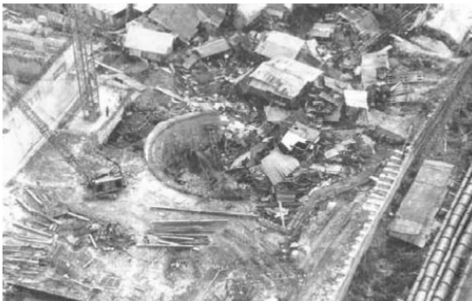
Рисунок 8.16 – Майданчик насосної станції після аварії
