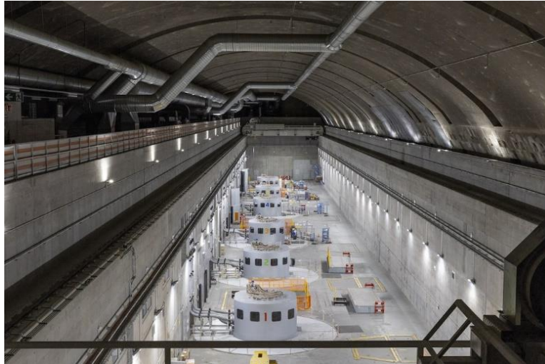
Рисунок 4.46 – Машинна зала підземної гідроакумулюючої електростанції Nant de Drance, Швейцарія
