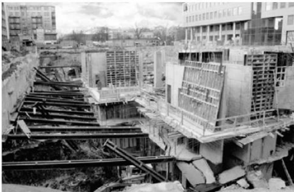
Рисунок 8.18 – Вигляд з кута стіни котловану, що обрушилася у Варшаві
