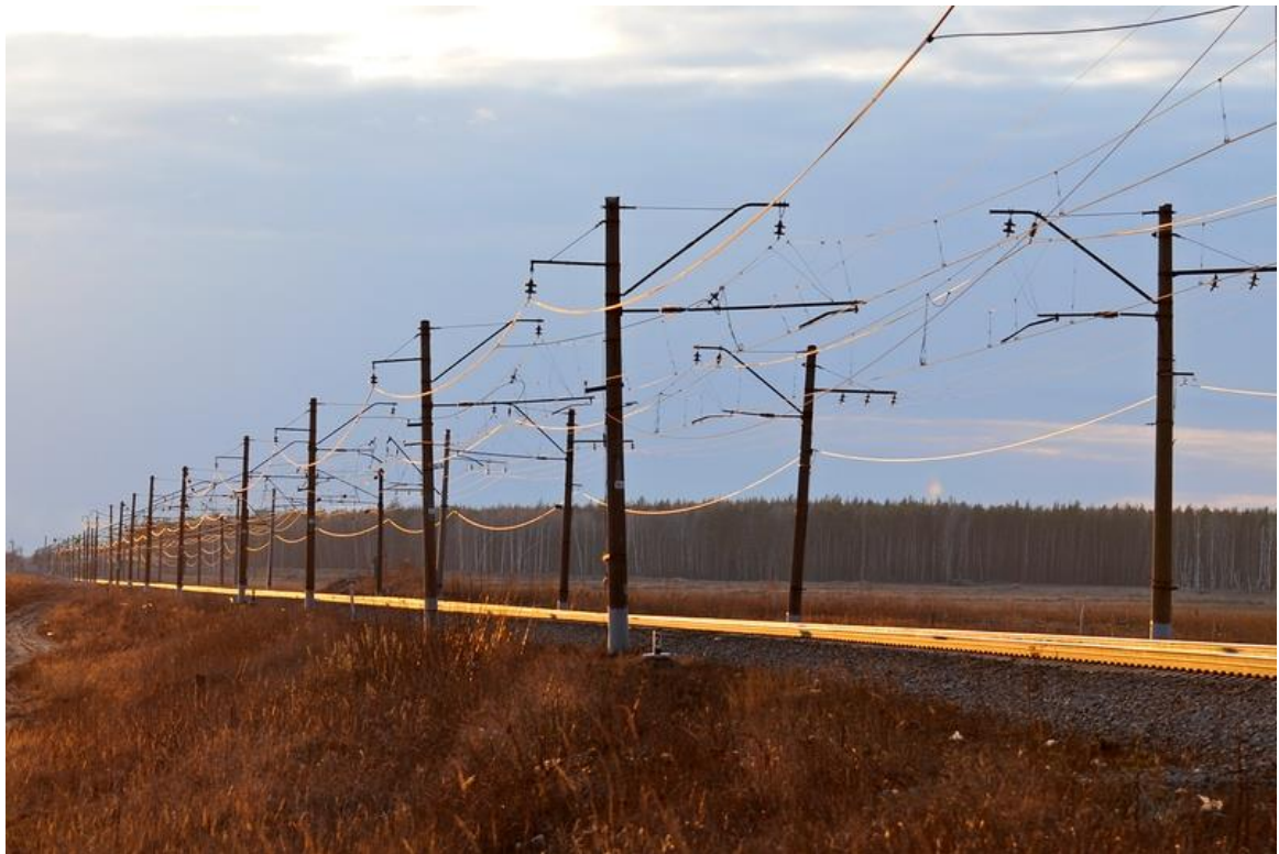
Рисунок 1.1 – Залізничні опори лінії електропередач
