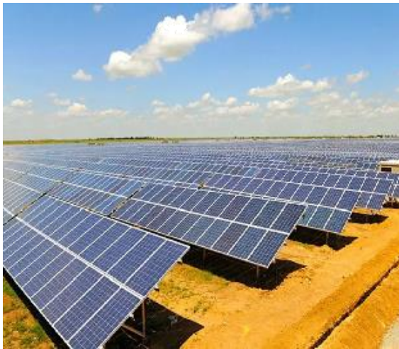
Рисунок 1.2 – Сонячна фотоелектрична станція
