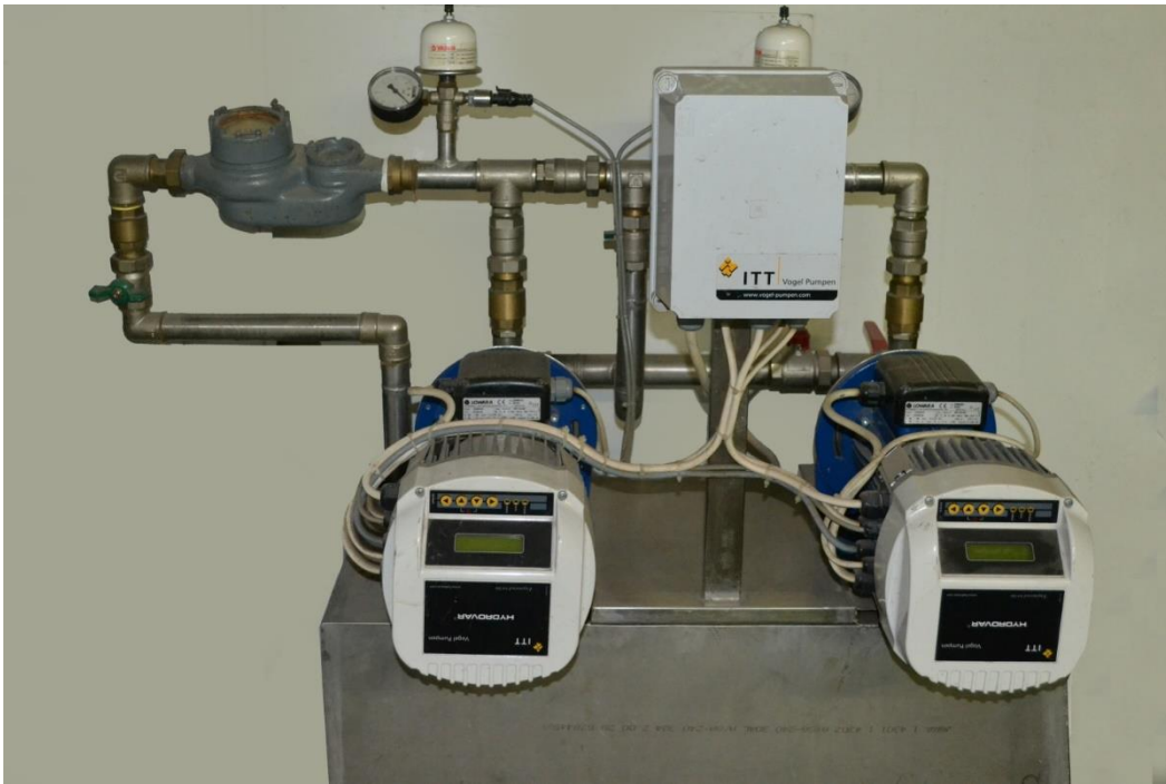
Рисунок 1.7 – Фото лабораторної установки насосів LOWARA з регульованим приводом
