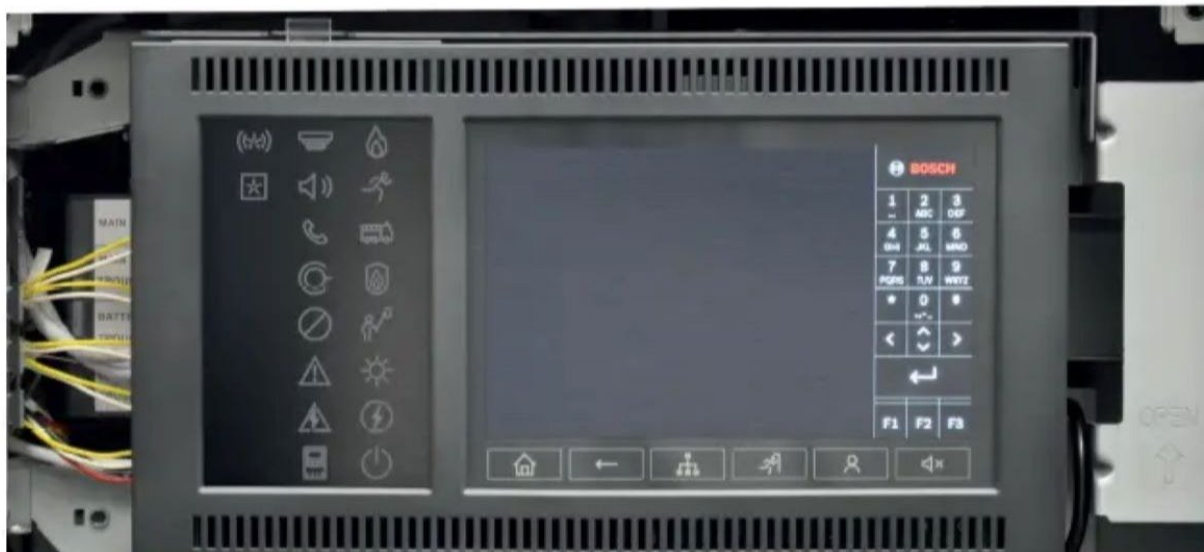
Рисунок 3.1 – Автоматична адресна система пожежної сигналізації Bosch AVENAR
