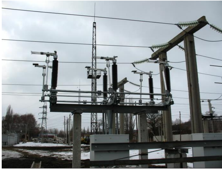
Рисунок 3.1 – Підстанція 110/35/10 кВ, що розташована в місті Берестин
