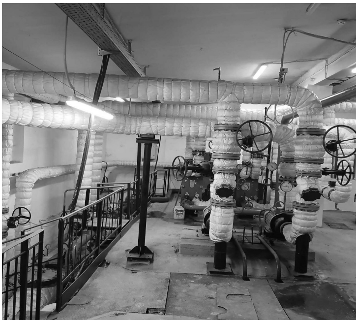
Рисунок 8.9 – Підмішуючі насоси системи опалення
