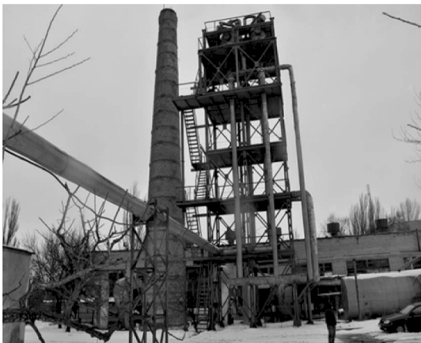
Рисунок 12.3 – Вакуумна деаераційна установка на котельні м. Запоріжжя
