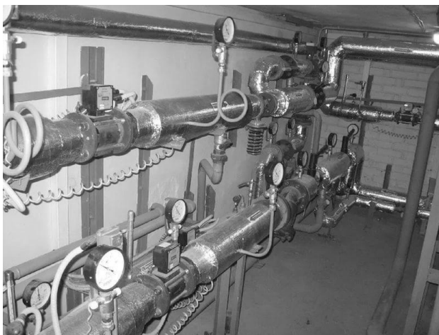
Рисунок 3.2 – Фото вузла обліку тепла на теплорозподільчій станції [URL: https://termoprom.com.ua/uk/poslugi/servis/servis-uzlov-ucheta-tepla. ]
