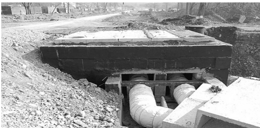
Рисунок 7.37 – Фрагмент підземної теплової камери в ґрунті
